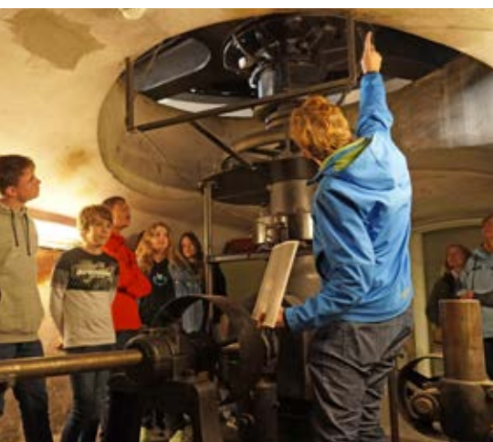
Beim Besuch des Kleinwasserkraftwerks Untermühle erfahren die Schülerinnen und Schüler viele spannende Details.
